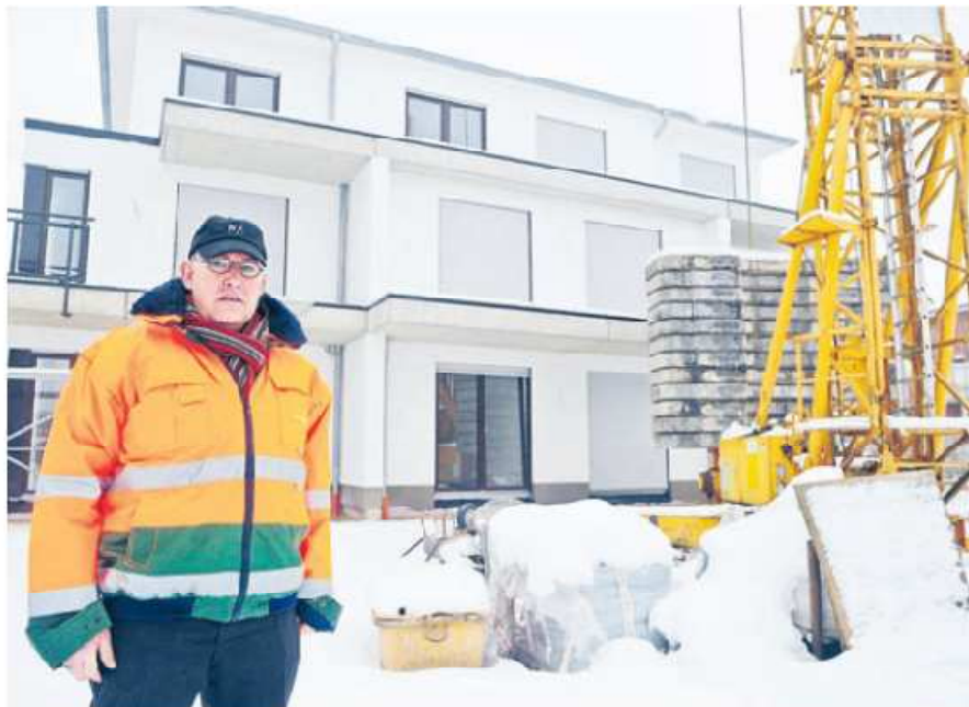
Alle Maschinen stehen still. Auf den Baustellen im Landkreis (hier an der Hauptstraße in Leeste) geht im Winter nicht viel Schnee und Eis sorgen vielerorts für einen Baustopp. FOTO: PHOTOUBE
