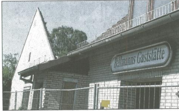
Nicht mehr lange, und es dürfte auch die freistehende Wand des ehemaligen Gasthauses Bellmann erwischen. ■ Foto: Hapke
