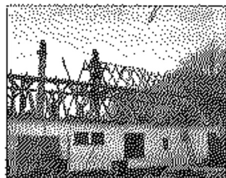
Weil der Dachstuhl der früheren Varreler Hofstelle von Schädlingen befallen war...
